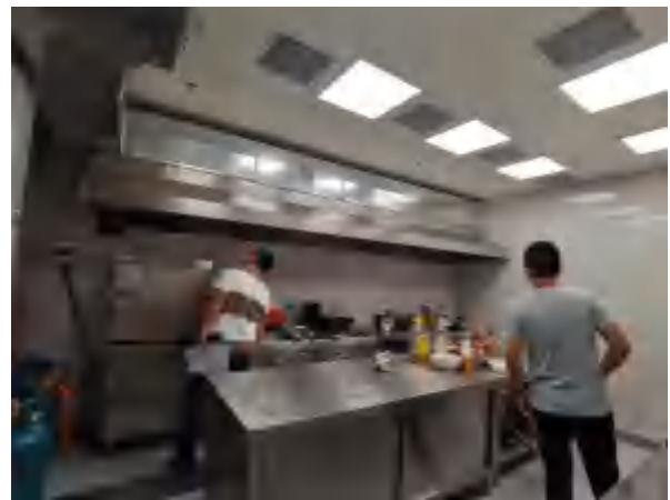
厨房油烟收集管道
