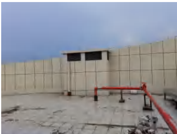
厨房油烟及发电机废气排气口
